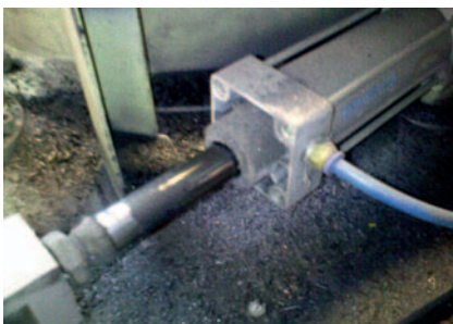
Fot. 2. Szczelność układów pneumatycznych daje realne oszczędności
